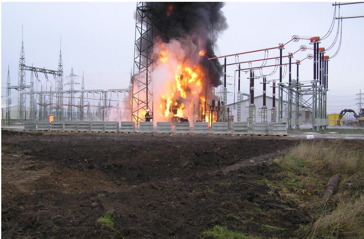
Obrázek 2 Požár transformátoru v TR Vyškov [2]
